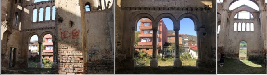
Yapının batı cephesindeki uç kemerli girişi, galeri katı döşeme izleri (solda), giriş cephesinde vandalizm izleri, sıvada dökülmeler (ortada), güney cephesi girişinde görülen bozulmalar (sağda) (Yazarlara ait fotoğraf arşivi, 2019)
