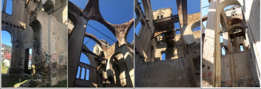
Yapının naosa açılan yıkık duvarı, vandalizm izleri (solda), yapının yıkık üst örtüsü ve kulelere çıkan döşeme izleri (ortada), naosun yan mekanları, taşıyıcı ayaklarda görülen bozulmalar (Yazarlara ait fotoğraf arşivi, 2019)
