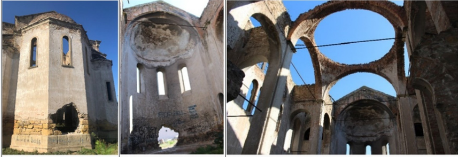
Yapının absid duvarındaki delik, sıva dökülmesiyle ortaya çıkan duvarlardaki lefke taşı (solda), absid duvarında ve kubbesinde görülen bozulmalar(ortada), yapının yıkık üst örtüsü ve taşıyıcı ataklar (sağda) (Yazarlara ait fotoğraf arşivi, 2019)
