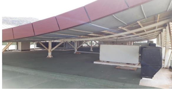
Şekil 5. Bodrum Yolcu İskelesi Isıtma – Soğutma Üniteleri
