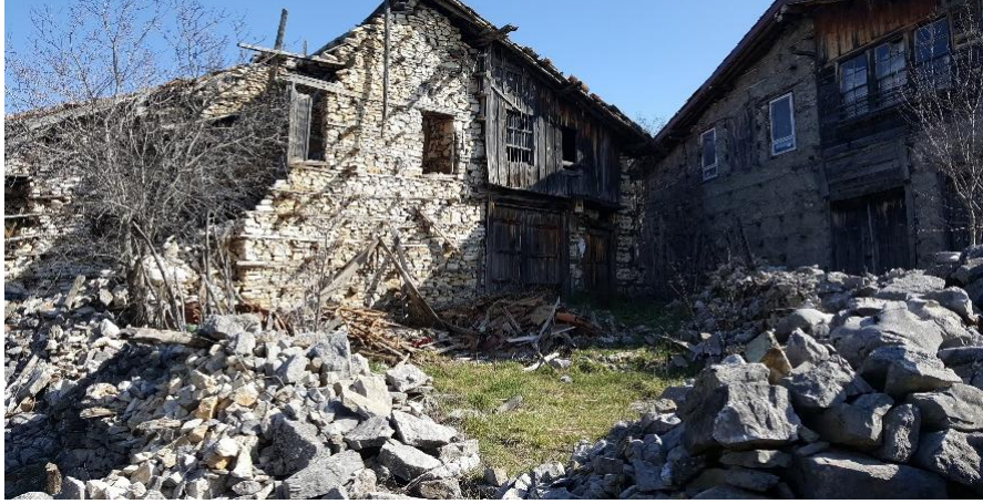
Resim 9. Köyde Bulunan Yıkık Yapılar
